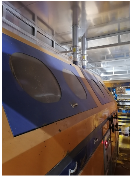
1#生产线中调直除锈一体机除尘收集系统
