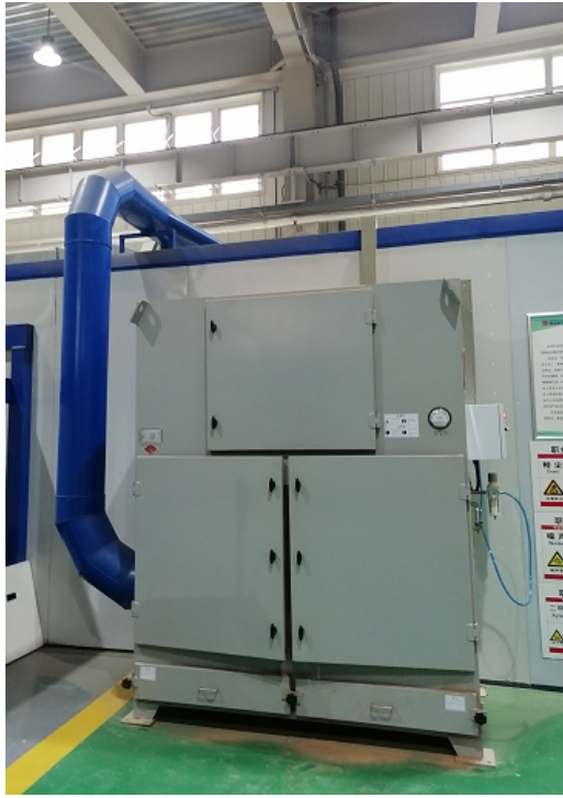
1#生产线调直除锈机设置的滤筒除尘器
